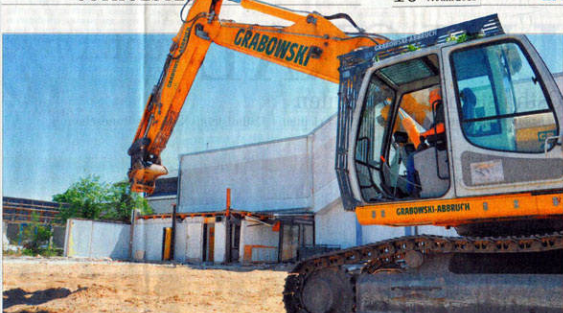
Der Bagger ist in Stellung, es kann losgehen mit dem Abriss des alten Tourismusbüros.
