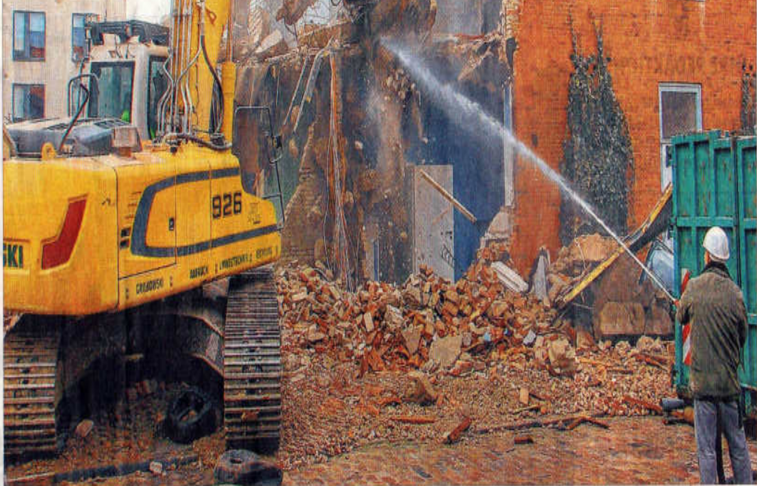
Bagger zerstören den Nachkriegsbau: Bald soll kein Stein der Hanse-Schule mehr auf dem anderen stehen.
